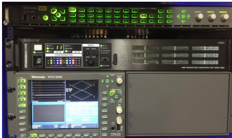
(4K HDR 轉換設備)
